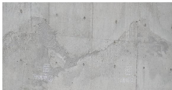
図-10 第二体育館壁面のコールドジョイント
