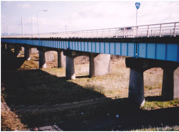
写真 1. 鉄道道路併用橋として建設された坂東大橋旧橋 (2004. 2. 15 筆者撮影)
