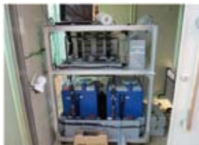
レドックスフロー蓄電池
